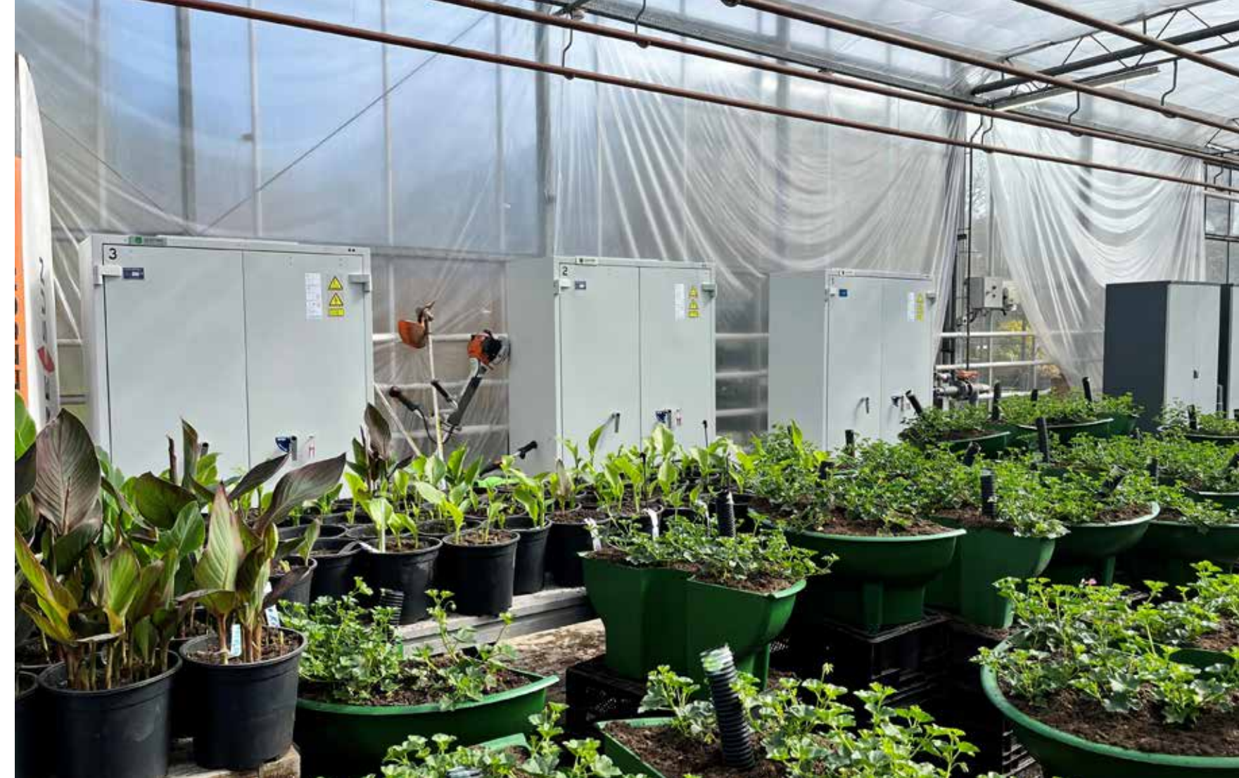
Drie Seefion accukluizen geplaatst in de locatie 'kas' in Den Haag.
